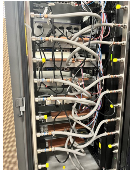
Recupero di calore di scarto diretto dai server
