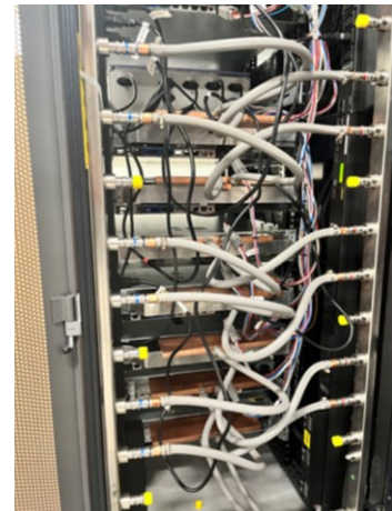
Hier wird die Abwärme direkt von den Servern zurückgewonnen
